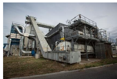
Pierrelatte Centrale de cogénération biomasse
